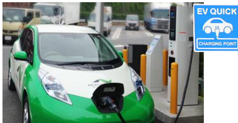
電気自動車急速充電器の設置
