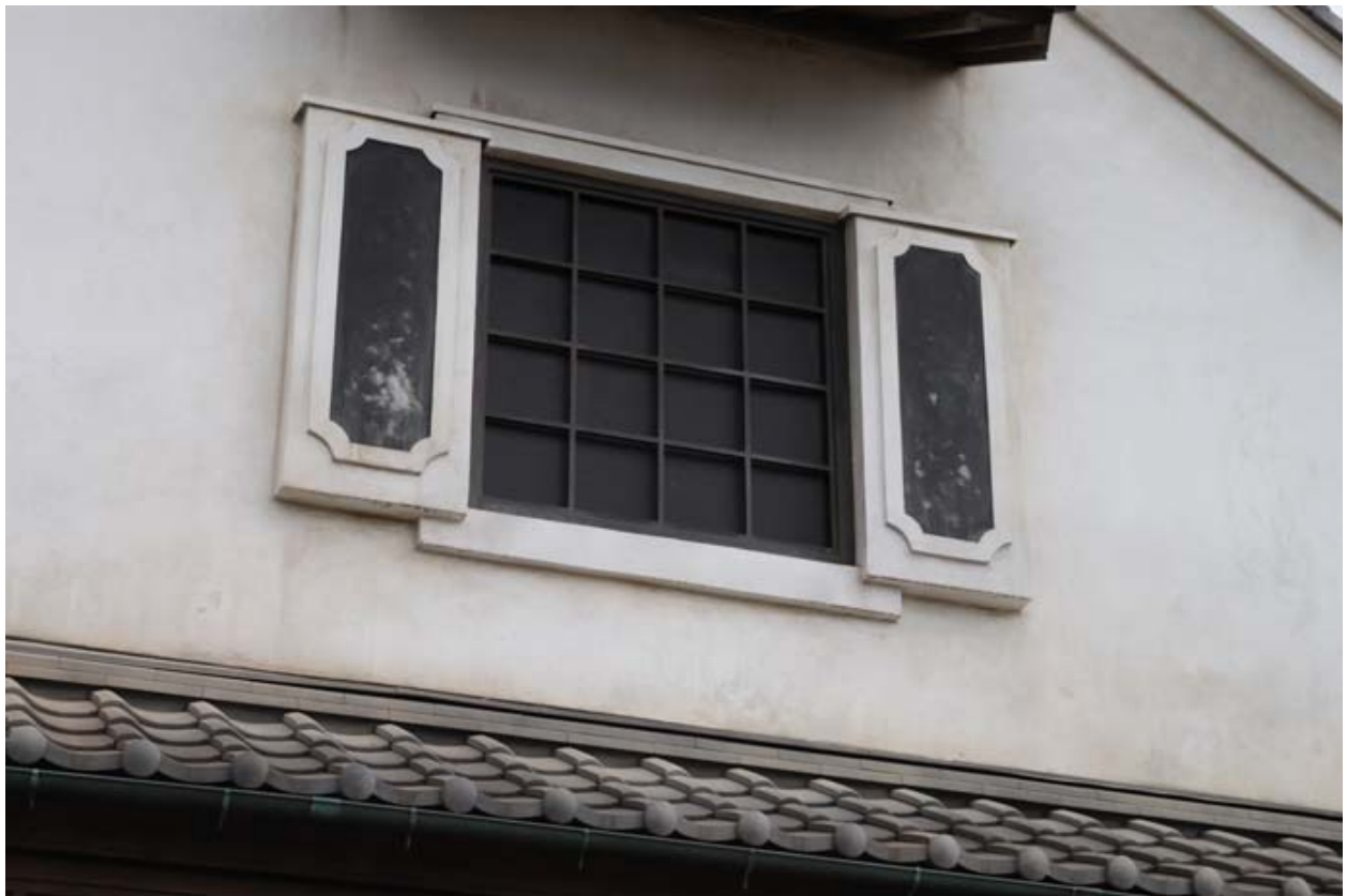
■ 蔵の雨水だれ、鑄鉄の白錆、古い瓦の様子
