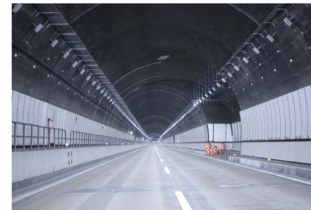
▲ LEDによるトンネル照明
