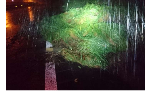
東北道(・山形道): 法面崩落
