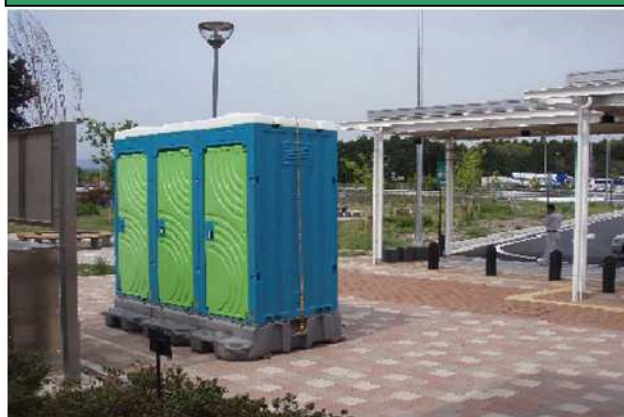
臨時トイレの設置
