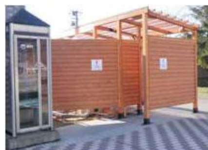
臨時トイレ設置状況
