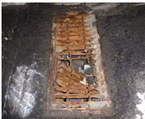
＜排水施設損傷状況＞
