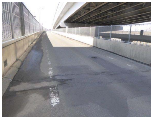
＜舗装損傷状況＞
