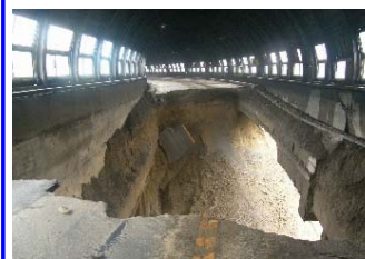
<②⑨三国の沢覆道損傷>
