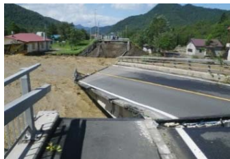
<①千呂露橋落橋>
