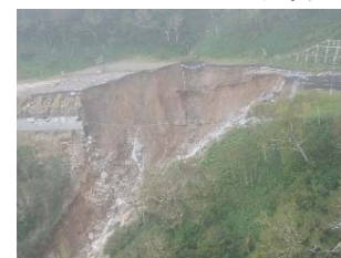
<④②帯広側7号目付近盛土崩壊>
