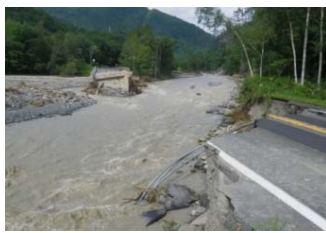
<⑦岩瀬橋落橋>
