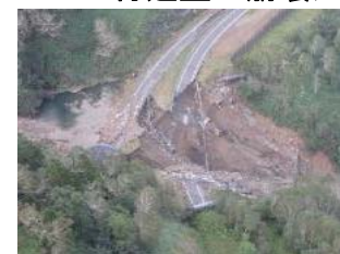
<③⑧帯広側8号目付近盛土崩壊>
