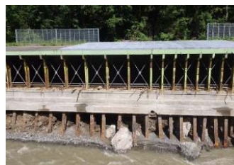
<⑩清瀬覆道損傷>
