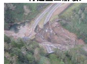
<38 帯広側8号目付近盛土崩壊>
