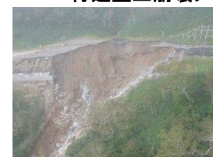
<42 帯広側7号目付近盛土崩壊>
