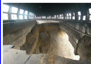
<29 三国の沢覆道損傷>
