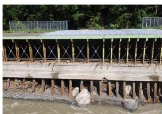
<10 清瀬覆道損傷>
