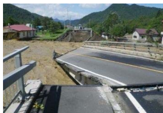
<1 千呂露橋落橋>
