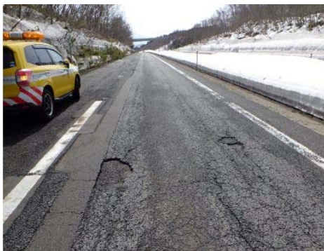
<舗装損傷状況>
