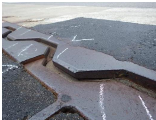
< 橋梁継ぎ目部段差状況 >
