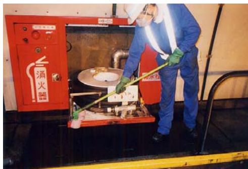
非常用設備清掃・点検
