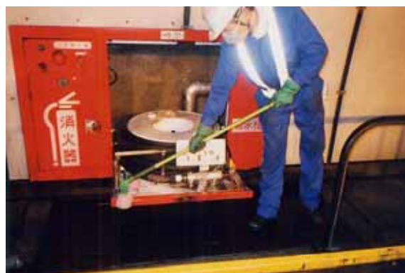
非常用設備清掃・点検
