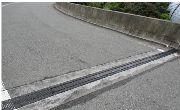
都筑IC 劣化現況
