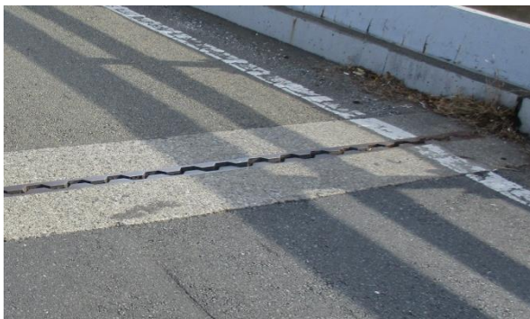
港北 IC 劣化現況
