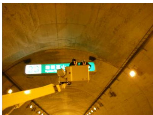
各種設備の点検・清掃
