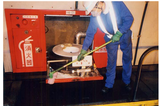
非常用設備清掃・点検
