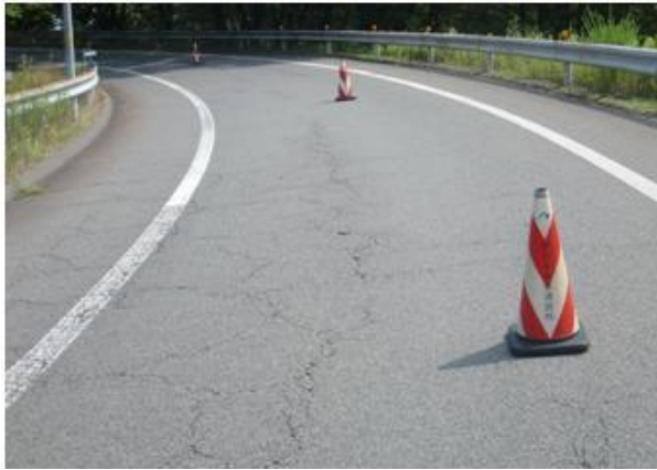
路面損傷状況
