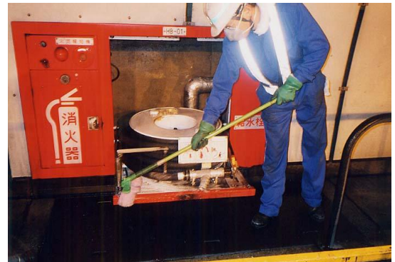
非常用設備清掃・点検
