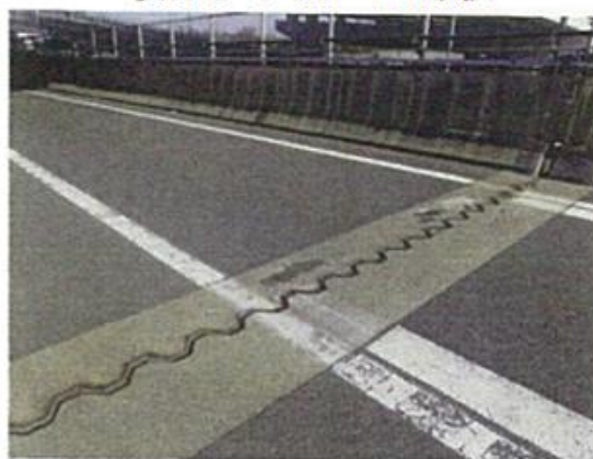
後打ちコンクリートの破損
