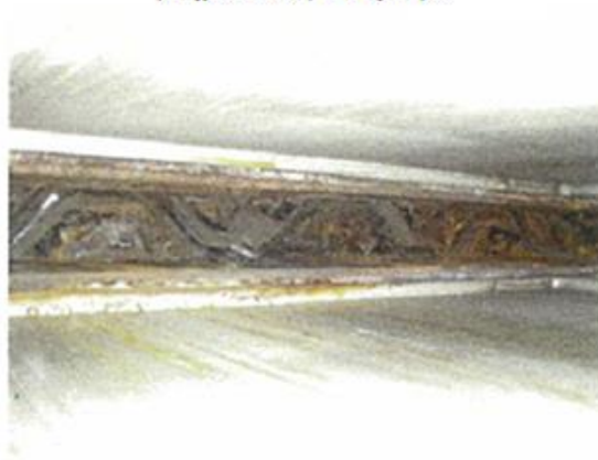
非排水装置の変状
