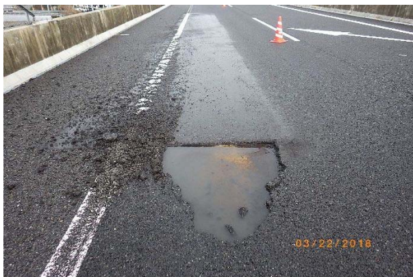
舗装損傷状況
