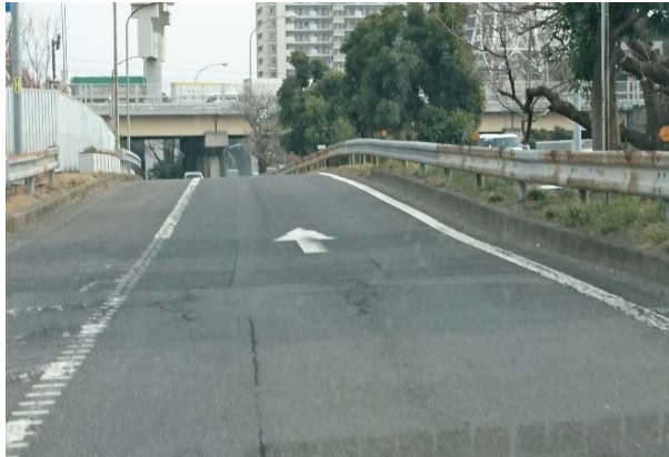
舗装劣化状況写真
