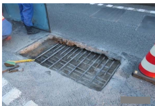
床版損傷写真
