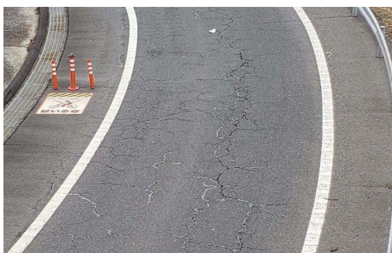
舗装劣化状況
