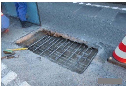
床版損傷写真
