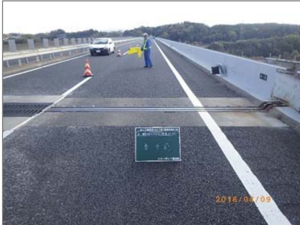
1. 損傷した伸縮装置
