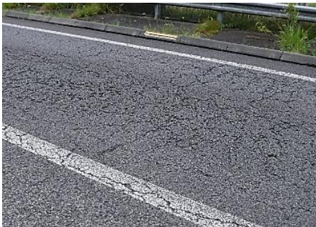
路面の損傷状況
