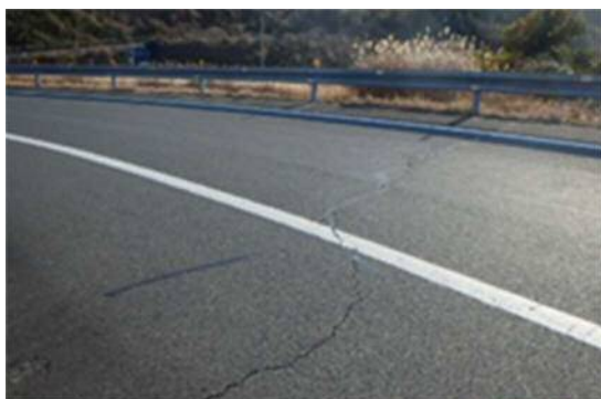
舗装劣化状況
