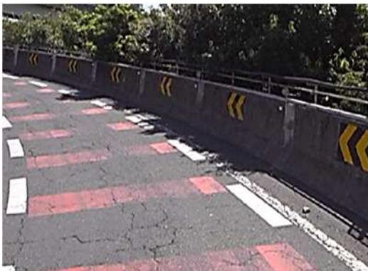
舗装損傷状況
