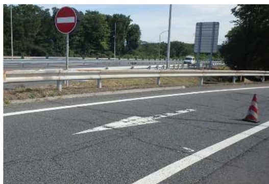
舗装損傷状況
