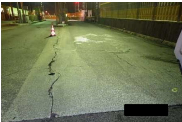
舗装劣化状況
