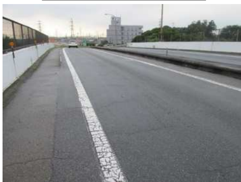
舗装損傷状況
