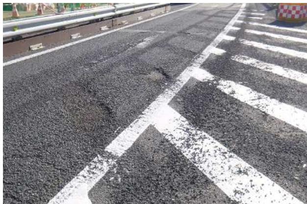
舗装劣化状況
