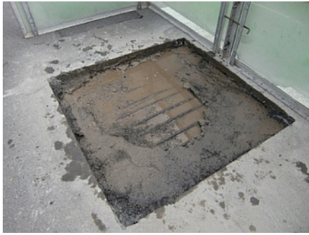
床版上面損傷発生状況
