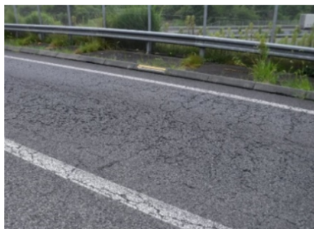
路面の損傷状況
