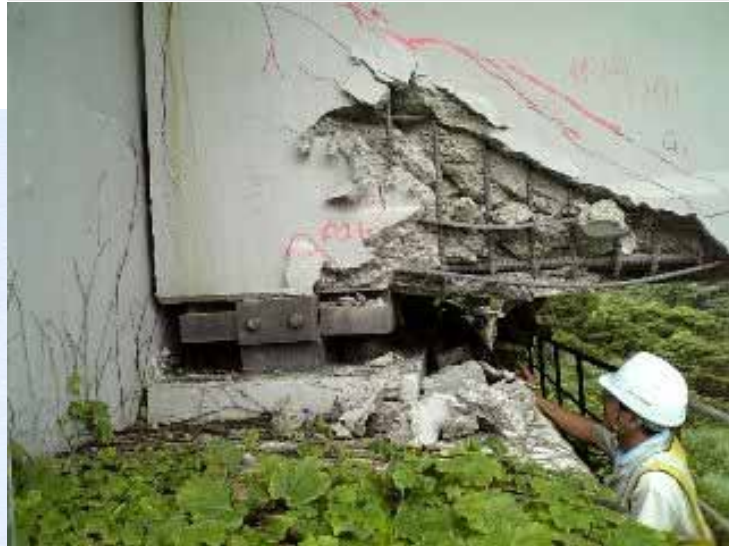
下り380.4KP (柿崎IC ~ 米山IC) 鉢崎橋 A1橋台 G1桁の損傷(路肩側より撮影)
