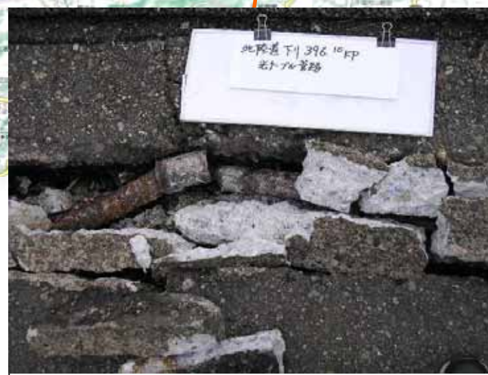
下り 396.1KP (米山IC ~ 柏崎IC) 光ケーブル管路破損(光ケーブル本体は損傷なし)
