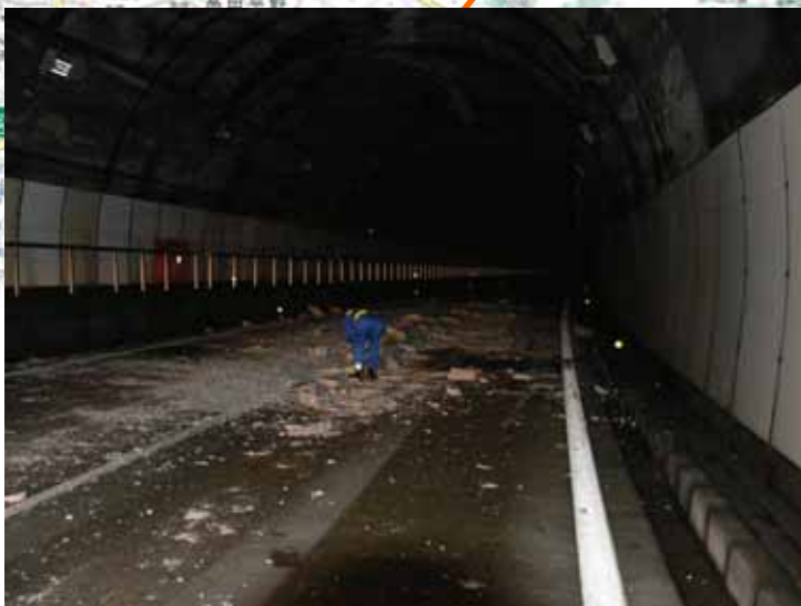
上り 381.8KP (柿崎IC ~ 米山IC) 米山トンネル 頂版コンクリートの角欠・剥落
