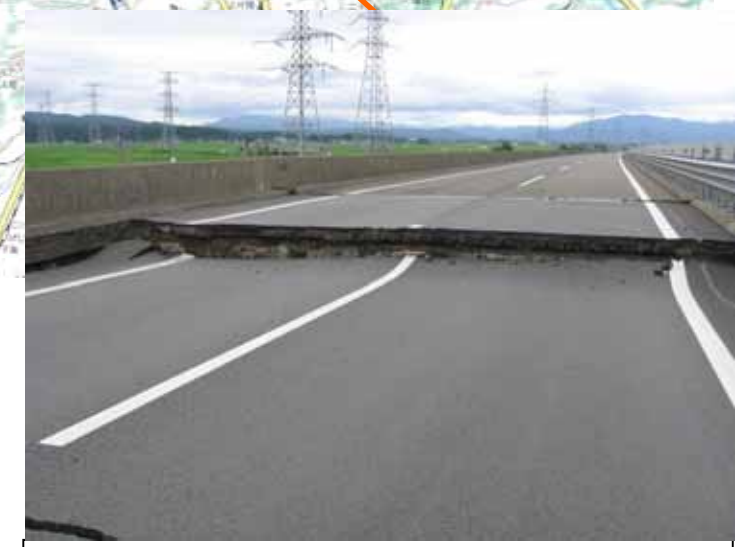
上り 402.2KP (柏崎IC ~ 西山IC) 吉井川橋 A1橋台付近 路面に著しい段差
