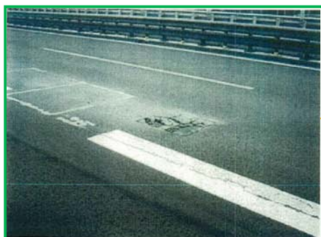
【舗装路面損傷状況】
