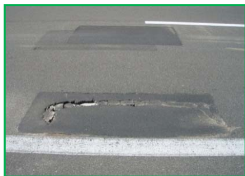
【舗装路面損傷状況】
