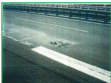
【舗装路面損傷状況】
