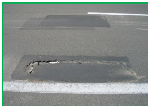
【舗装路面損傷状況】
