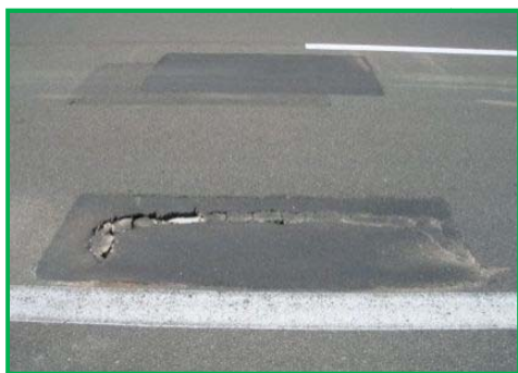
【舗装路面損傷状況】
