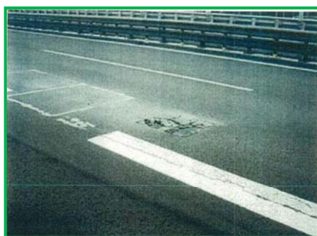
【舗装路面損傷状況】
