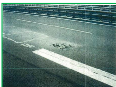
【舗装路面損傷状況】
