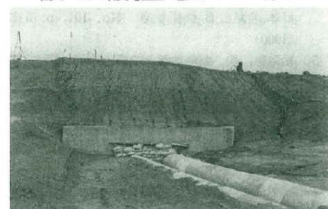
図16 水路ボックス上に発生したクラック
