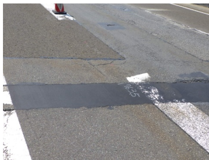
○路面損傷状況
