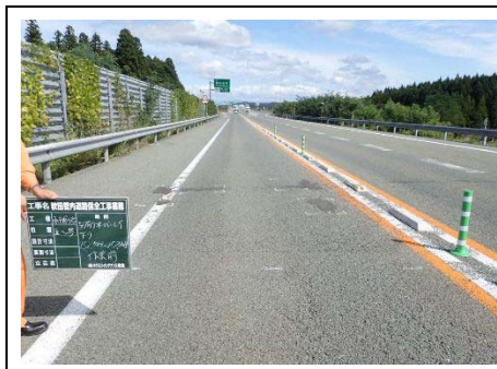
舗装損傷状況
