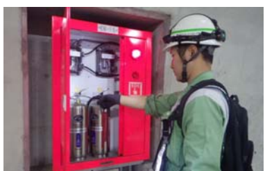
トンネル設備点検①
