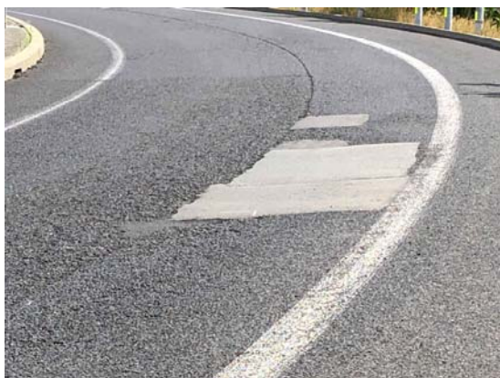
舗装の損傷状況図
