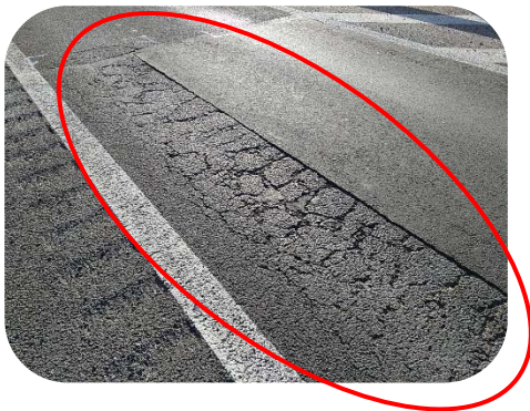
舗装損傷状況
