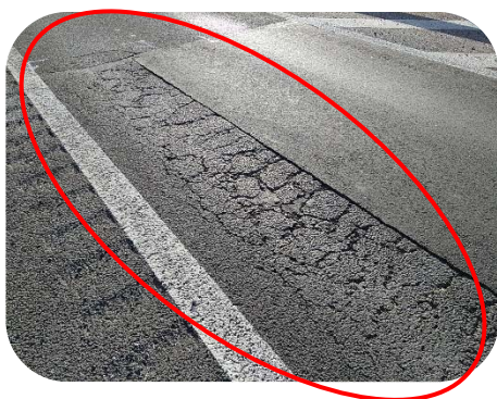
舗装損傷状況
